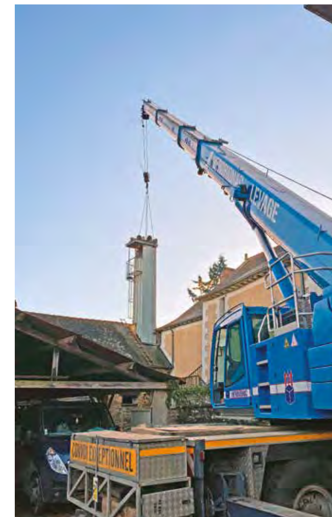
17 fév. Travaux grange : les travaux de réhabilitation de la grange située à l'arrière de la bibliothèque ont débuté. La sirène installée sur le toit a été démontée.
